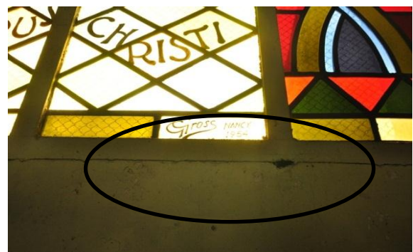
liaison acier - brique défectueuse
