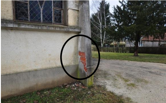
enduit et brique érodés
